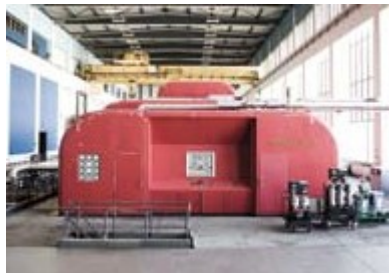
Generator på Stignæsværket 18 kV 266MW
